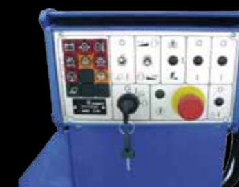
Quadro elettrico Electric panel
